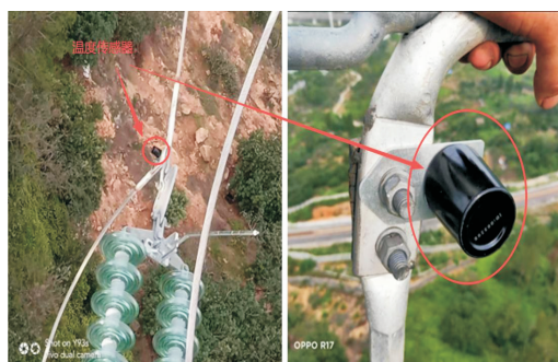
安装于 110kV 线路
