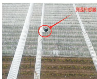
安装在 500kV 输电线路上的
