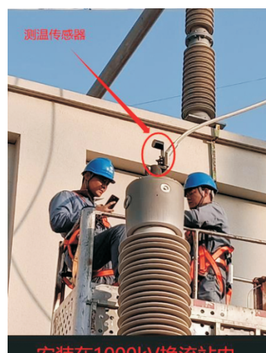
安装在1000kV换流站内
