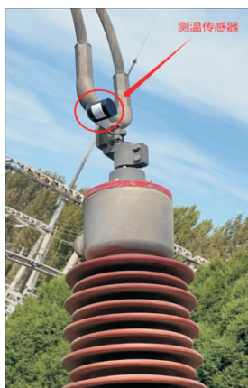
变电站内变压器高（中）压套管头测温
