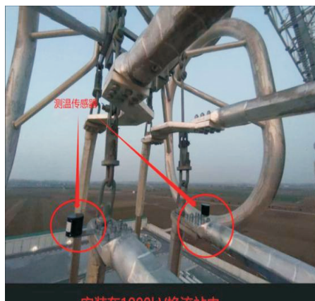
安装在1000kV换流站内
