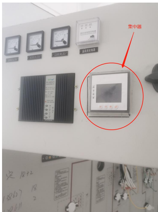
安装好的无线温度采集器正面
